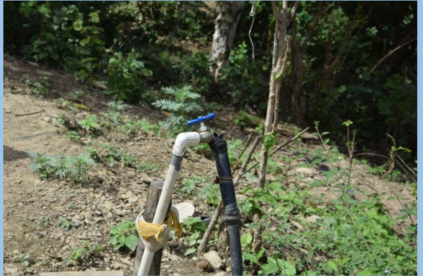
Agua potable Ur edangarria
